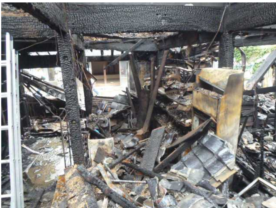
建物火災 現場写真
