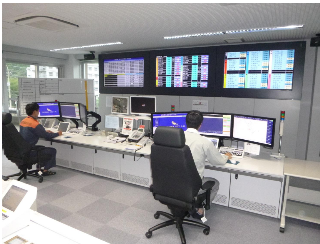
通信指令台システム
