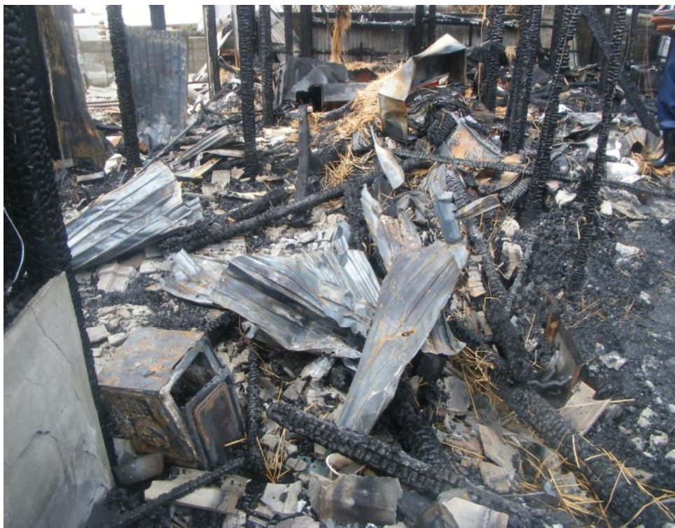
建物火災 現場写真
