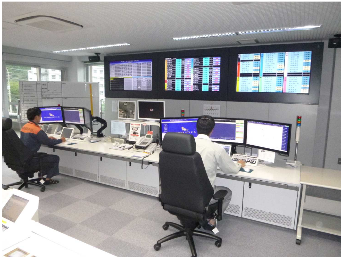
通信指令台システム
