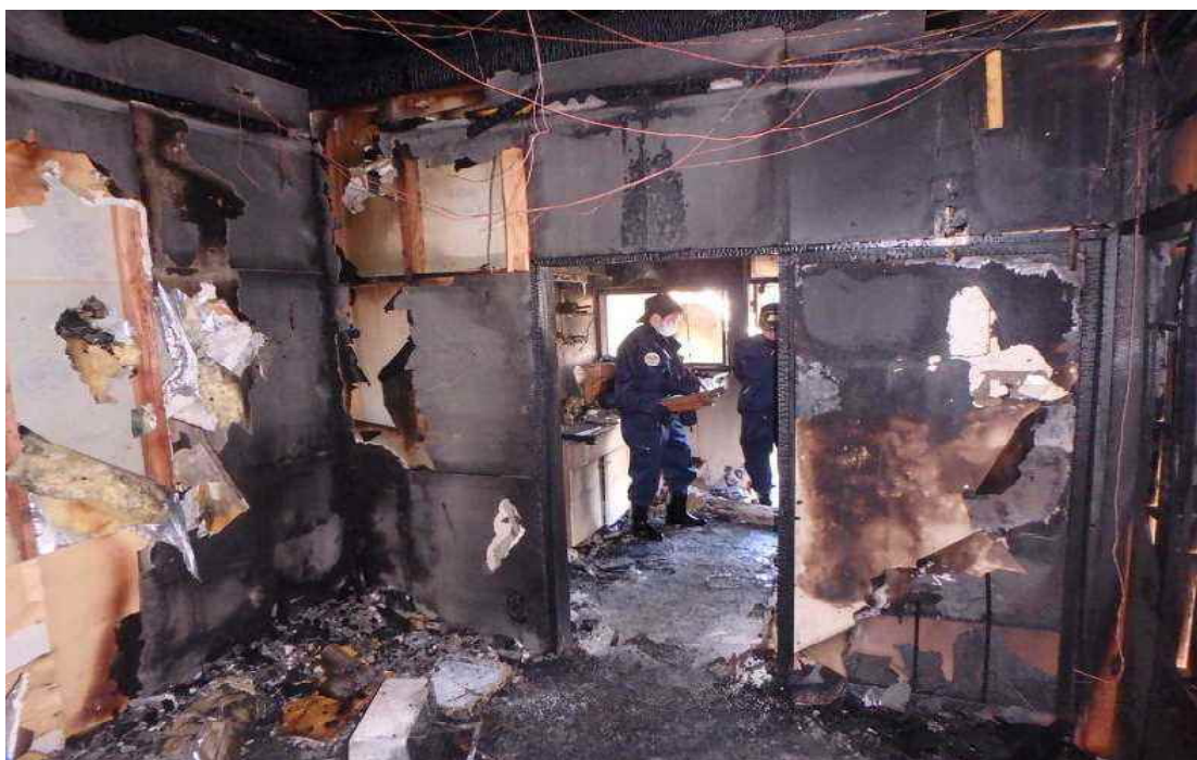
建物火災 現場写真
