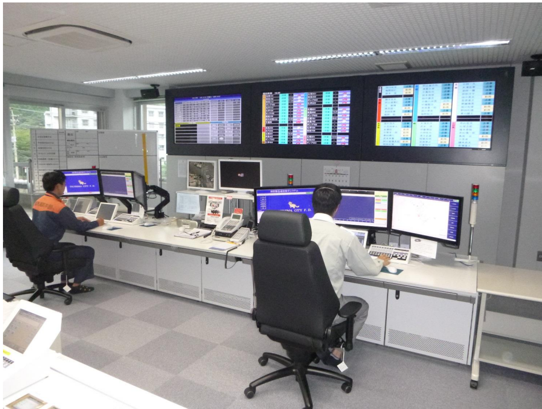
通信指令台システム
