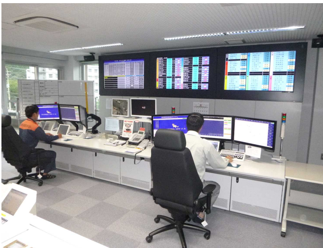
通信指令台システム
