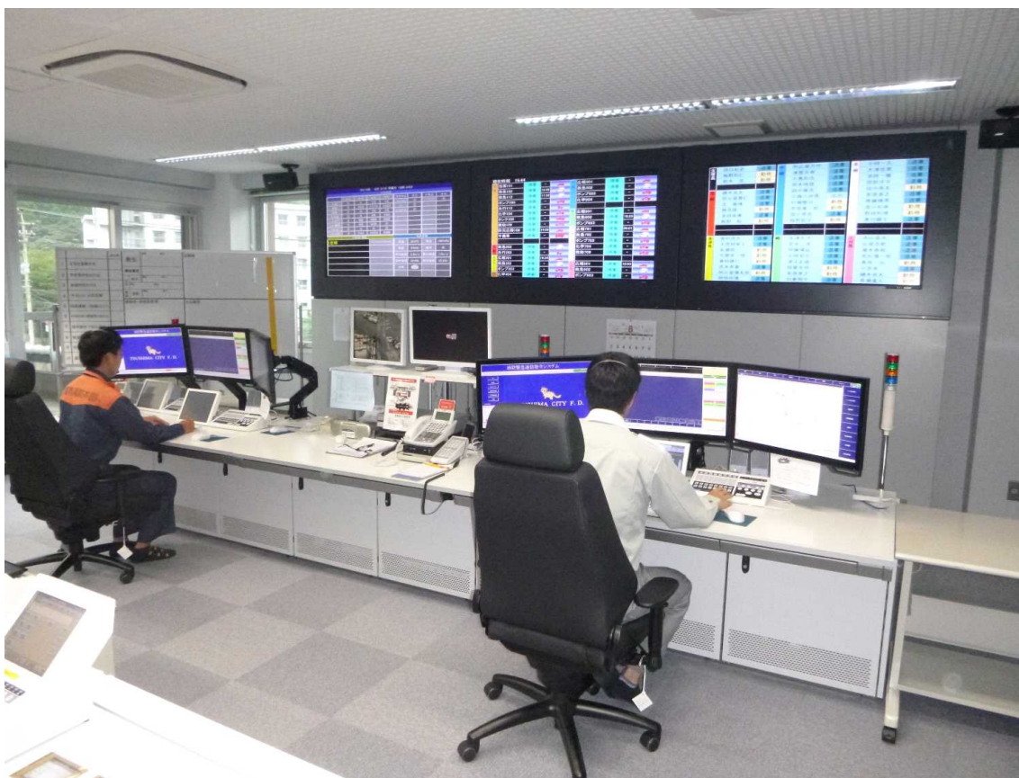
通信指令台システム
