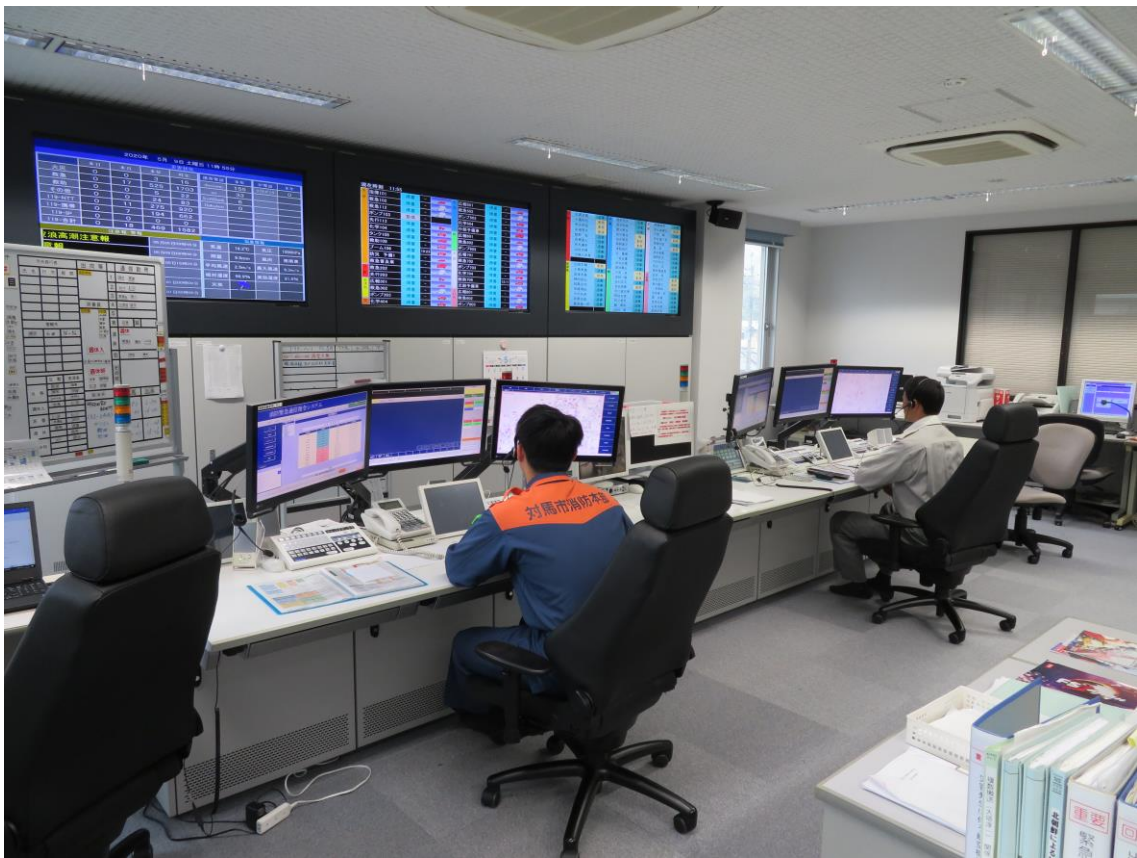
通信指令台システム
