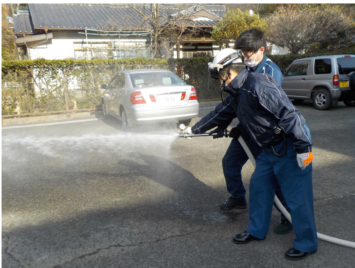
屋内消火栓放水圧力確認状況
