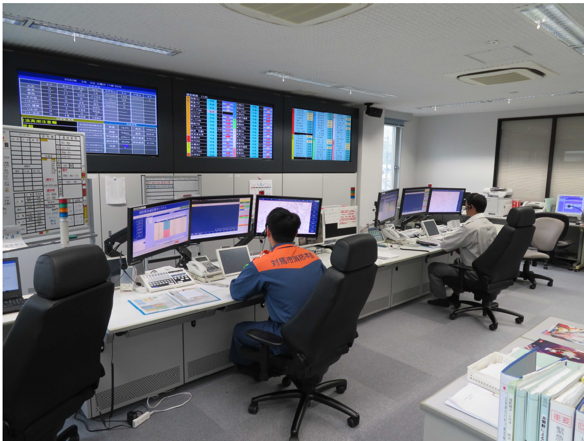
通信指令台システム
