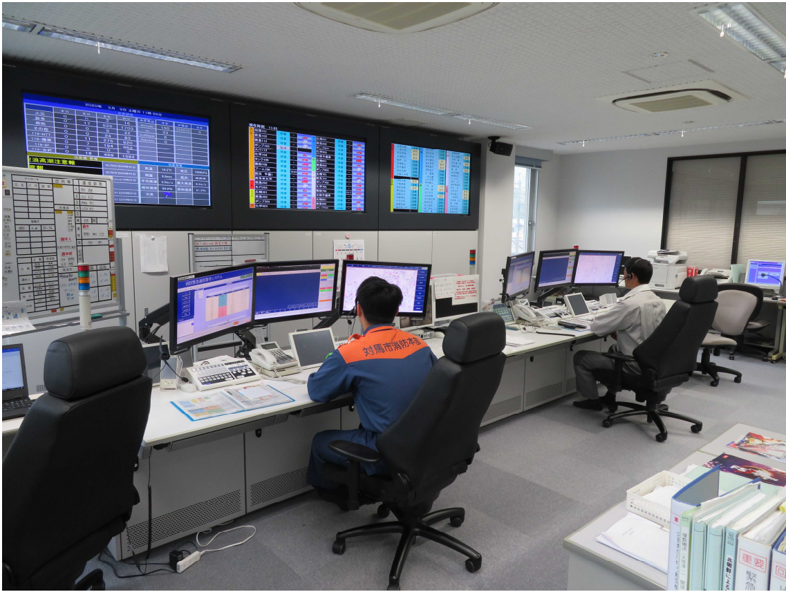
通信指令台システム
