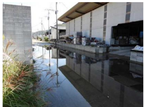
[大潮満潮時に海水で冠水した道路]
