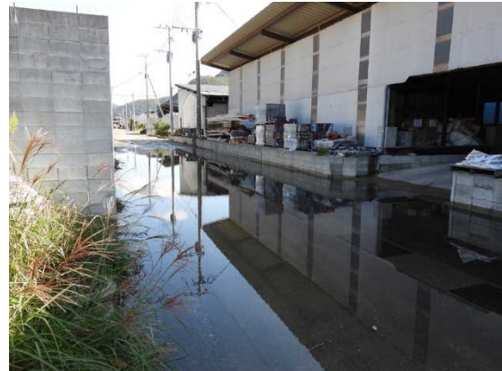
写真1 大潮満潮時に海水で冠水した道路
