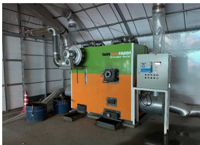
写真 12 原木しいたけの廃ホダ(木質バイオマス)を燃料とするボイラー。新たなしいたけ生産の熱エネルギーとして利用されている (厳原町佐須)
