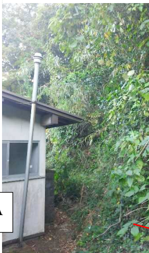
A、家屋背後の斜面崩壊防止 工事を要望
