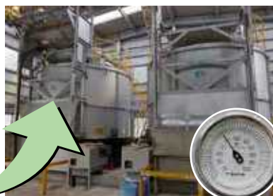
堆肥化施設 (美津島町根緒)
