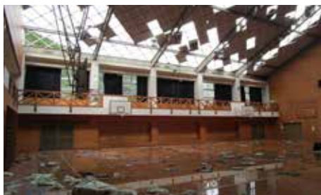
屋根が損壊した久田中体育館
